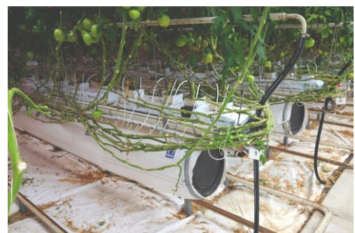
写真 2 外気導入のためのダクト *2
