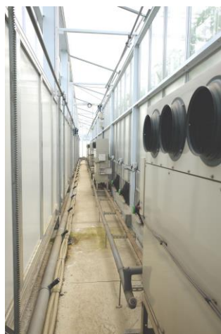
写真 1 空気を混合する コリドー *1
